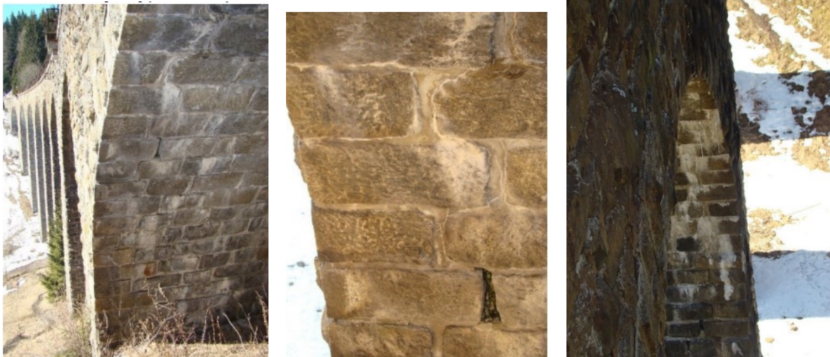
Obr. 3, 4, 5 Trhlina s výluhom vápnika, vypadané škárovanie, kvaple na pilieri
